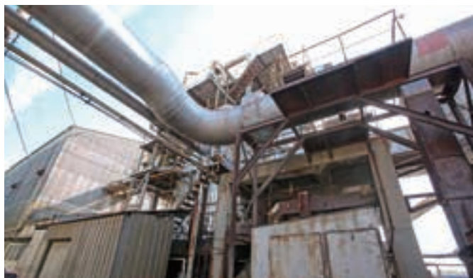
廃棄木材チップを燃料とするバイオマスボイラー
