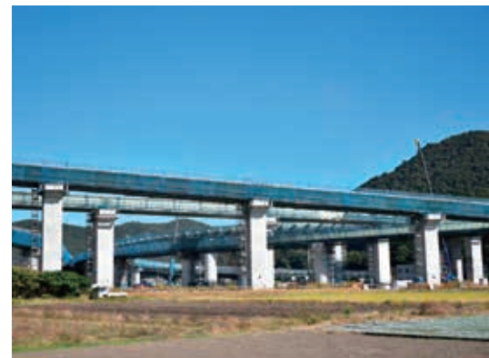
写真1 東海環状自動車道岐阜インターチェンジ(仮称)付近の工事の様子(2023年10月、筆者撮影)
