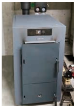
木質バイオマスボイラー 燃料は薪。お風呂や給湯などに利用。
